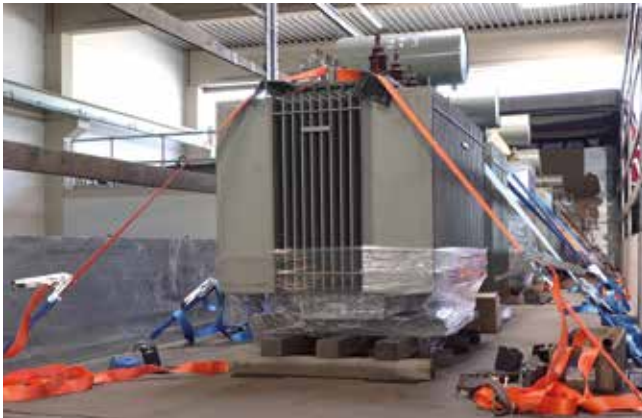
Vorbereitungen für den Abtransport in die Ukraine – Trafos aus Kassel für das Stromnetz im Osten des zerstörten Landes.
