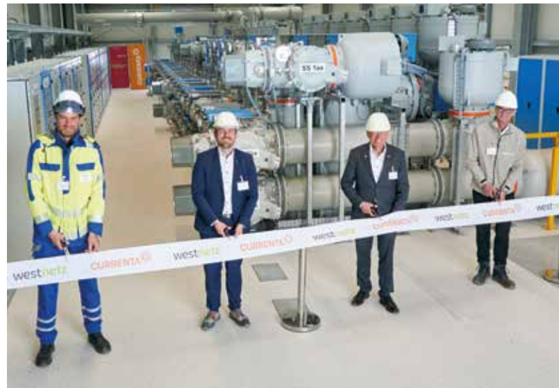
Bei der Einweihung der Schaltanlage im Chempark Dormagen: Patrick Wittenberg (Geschäftsführer Westnetz), Bürgermeister Erik Lierenfeld, Landrat Hans-Jürgen Petrauschke und Hans Gennen (Geschäftsführer Currenta) (v.l.n.r.). (Foto: Westnetz GmbH)
