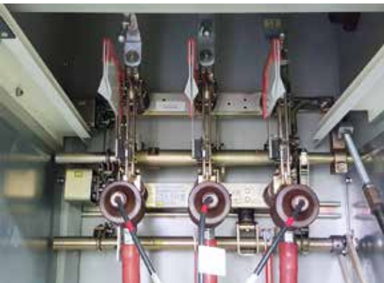
Der Spannungssensor C1A2-24 ist am Mittelspannungskabel auf der Sammelschiene installiert.
