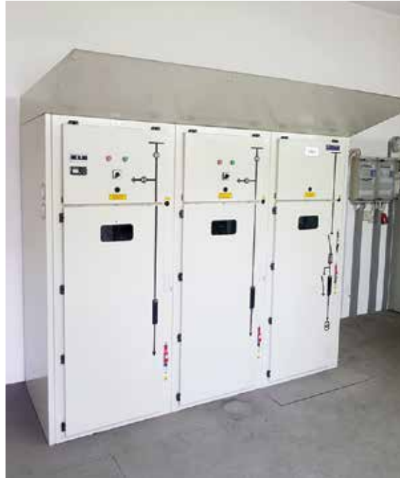
Erfolgreiches Retrofit: Kurz- und Erdschlussrichtungsanzeiger sowie ein integriertes Spannungsprüfsystem in einer luftisolierten Schaltanlage (Foto: Horstmann GmbH)
