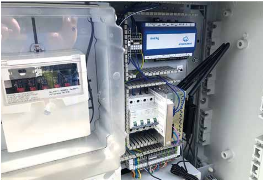
Über den Datenlogger cloud.log werden die Solaranlagen gesteuert und Daten, z.B. von den Wechselrichtern, an die Cloud-Plattform übertragen. (Foto: ampere.cloud GmbH)
