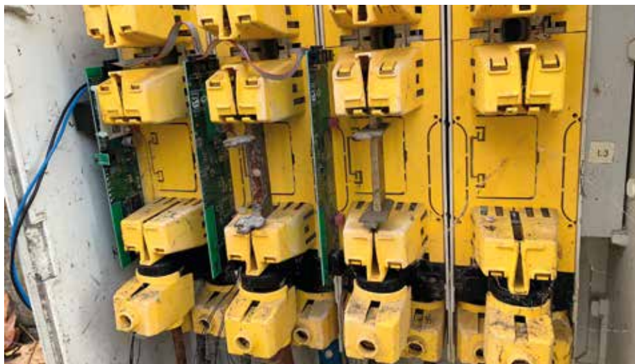
Das selbst entwickelte Sensor-Board misst und überträgt relevante Daten aus den Kabelverteilerschrank. (Foto: RheinEnergie AG)
