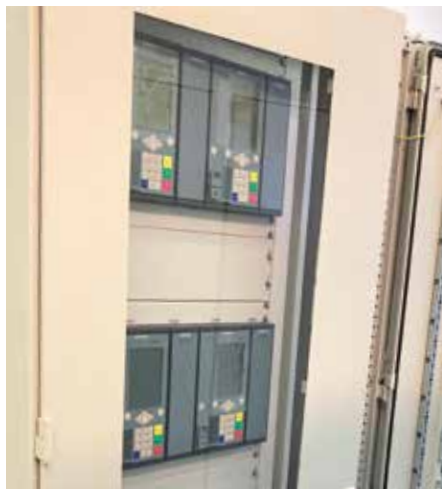
Im Umspannwerk Steinburg wurden insgesamt acht neue Schutzgeräte („intelligente Wachhunde“) eingebaut, die insgesamt bis zu 16 Schaltfelder bedienen könnten. (Foto: ©HanseWerk-Gruppe)
