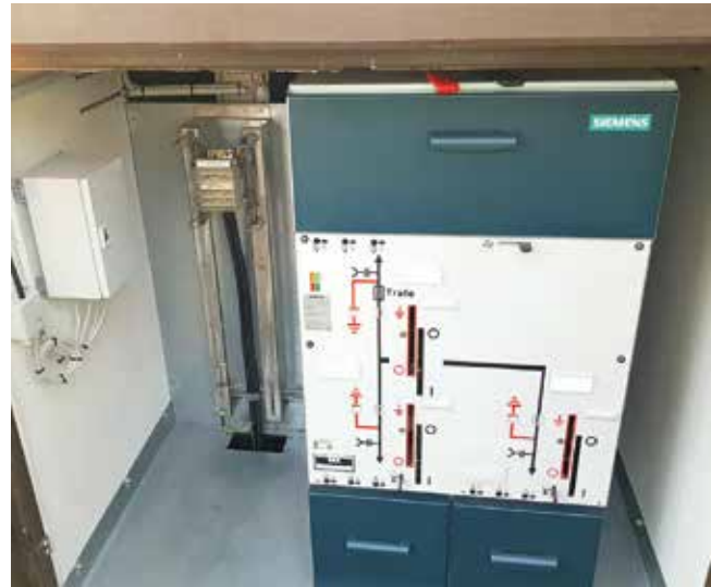
Gasisolierte Schaltanlage, aufgerüstet mit modernem Kurzschlussanzeiger und LoRaWAN.
